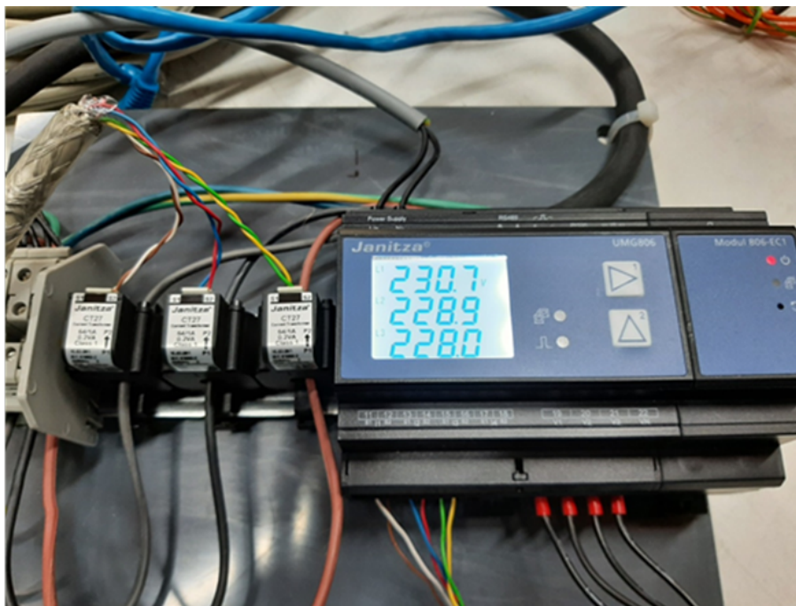
Abbildung 13: Energiemessgerät der Fa. Janitza vom Typ UMG806 mit drei Drehstromwandlern und einem Ethernet Kommunikationsmodul 806-EC1. Foto vom Testaufbau
